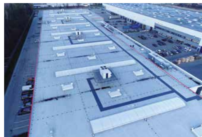
Figura 9: Ejemplo de instalación en un almacén o centro logístico ©FLOWAIR
