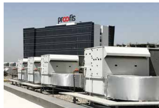
Figura 8: Ejemplo de instalación en un edificio comercial ©Untes
