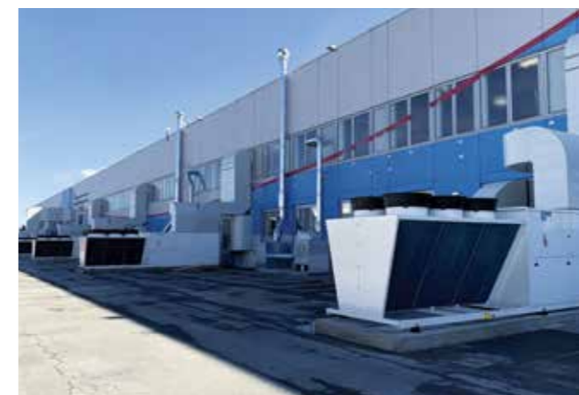
Figura 10: Ejemplo de instalación de producción industrial ©Clivet
